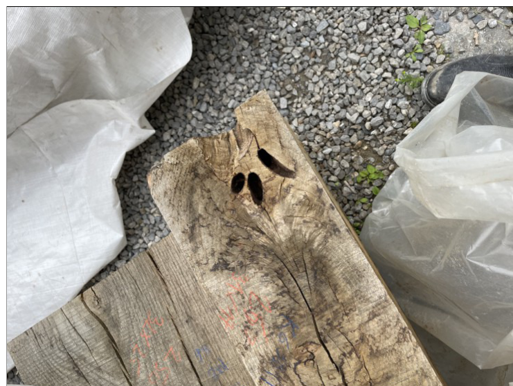
(c) Origin Architecten - Houtaantasting met uitvliegopening
